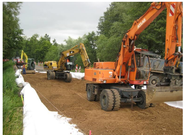
Einbau einer Geogittermatratze aufgrund des schwach tragfähigen Baugrunds unterhalb der Fahrbahn der Bundesstraße
