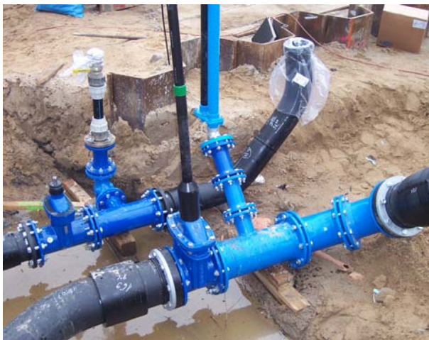
Knotenpunkt der Abwasserdruckrohrleitung mit Absperrschieber und Spülarmatur sowie Knotenpunkt der Trinkwasserleitung mit Absperrschieber und Abgang für Unterflurhydrant
